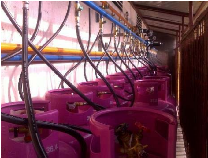
1. Hệ thống dàn bình gas rút lồng
