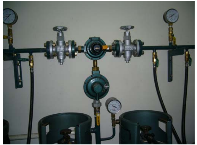
4. Hệ thống van điều áp cấp I + Tách lỏng
