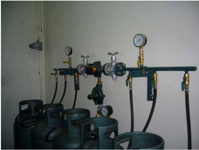
1. Hệ thống dàn bình
