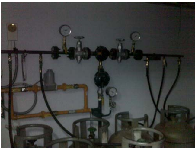
3. Hệ thống van điện từ ngắt khẩn cấp
