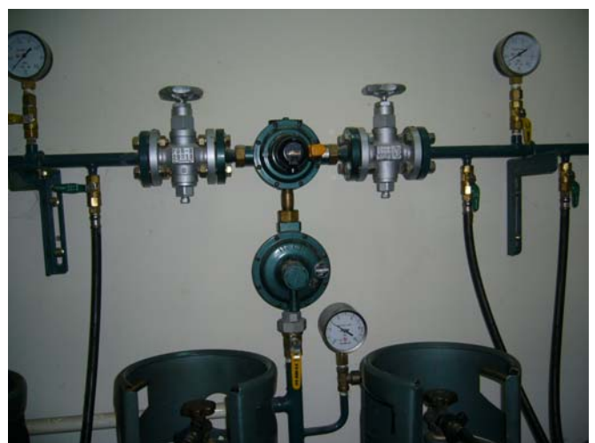
6. Hệ thống dàn bình
