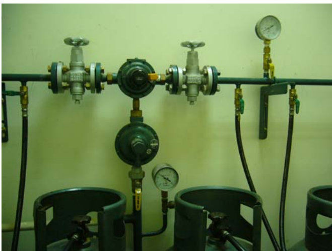
5. Hệ thống dàn bình
